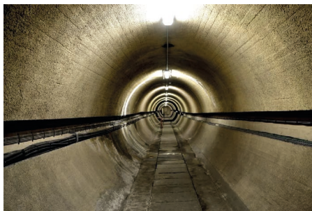
Figure 9 - Contrôle du barrage : dans ce couloir, les techniciens vont pouvoir vérifier que « tout est en service ».
