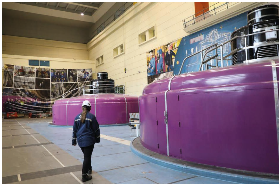
Figure 8 - Alternateurs de la centrale hydroélectrique.
